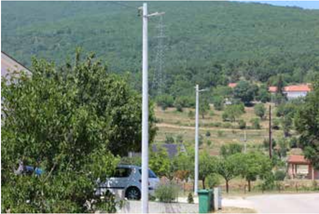
Dijelovi nove rasvjetne infrastrukture
